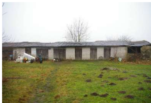
Būve ar kadastra apzīmējumu 6452 012 0094 004, Būve ar kadastra apzīmējumu 6452 012 0094 005 un Būve ar kadastra apzīmējumu 6452 012 0094 006
