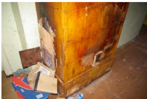
Būve ar kadastra apzīmējumu 6452 012 0094 001, dzīvoklis Nr.1, telpa Nr.4, krāsns
