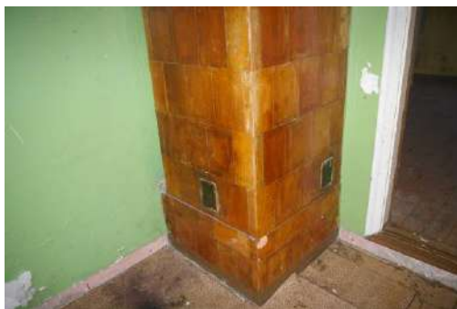
Būve ar kadastra apzīmējumu 6452 012 0094 001, dzīvoklis Nr.1, telpa Nr.5, krāsns
