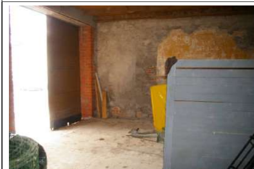
Būve (garāžas ēkas) ar kadastra apzīmējumu 6405 010 0184 001 elektroenerģijas pieslēguma punkts
