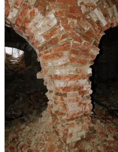
Bīstami erodējis velvju pārseguma balsts
