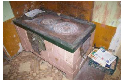
Būve ar kadastra apzīmējumu 6415 006 0041 001, dzīvoklis Nr.7, telpa Nr.1, plīts
