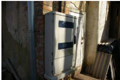
Dzīvojamā māja ar kadastra apzīmējumu 6409 003 0190 001, elektroenerģijas sadales un uzskaites punkts
