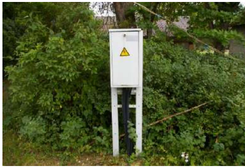
Zemes vienība ar kadastra apzīmējumu 6486 015 0143, elektroenerģijas uzskaitē un sadale
