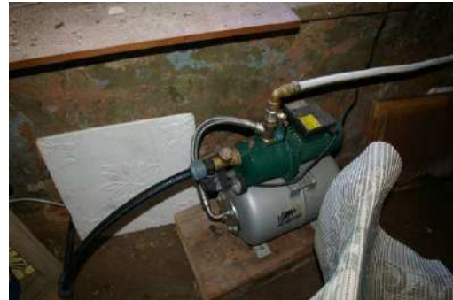
Dzīvojamā ēka ar kadastra apzīmējumu 6427 004 0035 001, 1.stāvs, ūdenssūknis
