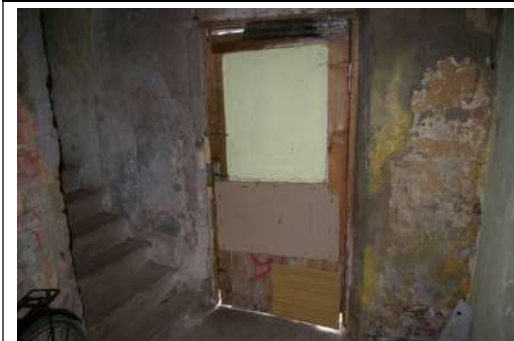
Būve ar kadastra apzīmējumu 6405 010 0192 001, koplietošanas telpa
