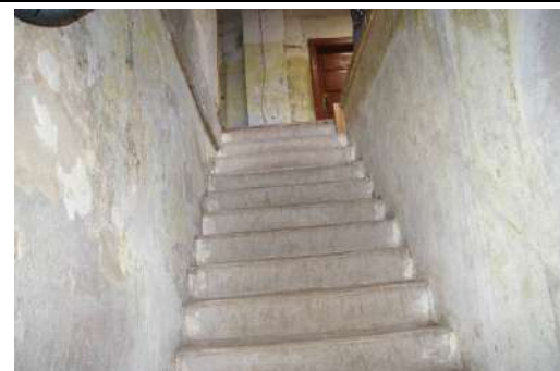
Būve ar kadastra apzīmējumu 6405 010 0192 001, koplietošanas telpa
