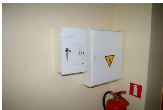
Būve (Bārtas pamatskolas ēka) ar kadastra apzīmējumu 6444 004 0171 001, 1.stāvs, ugunsdrošības vadības bloks
