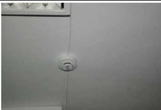
Būve (Bārtas pamatskolas ēka) ar kadastra apzīmējumu 6444 004 0171 001, 1.stāvs, ugunsdrošības sensors
