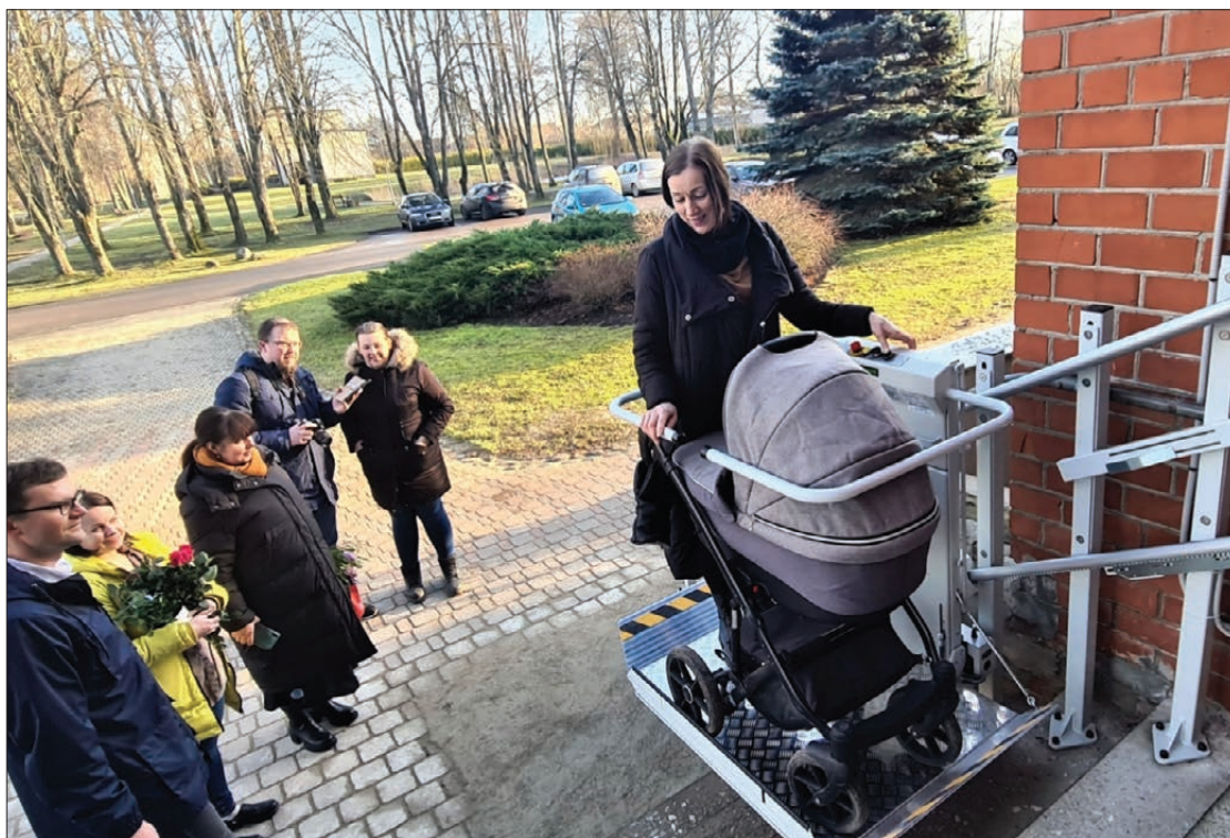
Pie Nīcas un Otaņķu pagastu apvienības pārvaldes ēkas Otaņķos, kur iekārtots arī feldšerpunkts, pagājušajā gadā uzstādīts lifts-pacelājs ar celtspeju 225 kg, kas nodrošina iedzīvotājiem ērtu pieejamību dažādiem pakalpojumiem.
