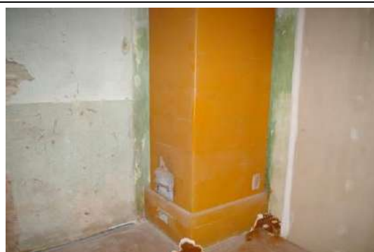
Dzīvojamā māja ar kadastra apzīmējumu 6468 003 0034 028, dzīvokļa īpašums Nr.4, telpa Nr.4, krāsns
