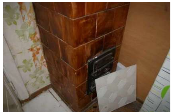
Būve ar kadastra apzīmējumu 6492 006 0873 001, dzīvoklis Nr.2, telpa Nr.2, krāsns
