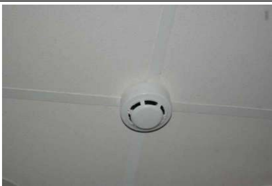
Būve (ēdnīcas ēka) ar kadastra apzīmējumu 6444 004 0242 001, dūmu detektors
