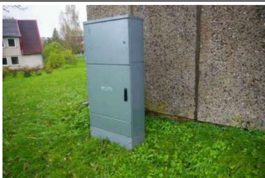
Zemes gabals ar kadastra apzīmējumu 6444 004 0242, elektroenerģijas pieslēguma punkts
