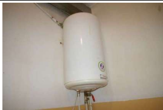
Būve (ēdnīcas ēka) ar kadastra apzīmējumu 6444 004 0242 001, siltā ūdens uzsildīšanas tvertne
