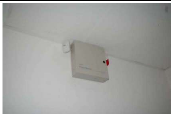
Būve (ēdnīcas ēka) ar kadastra apzīmējumu 6444 004 0242 001, apsardzes pults
