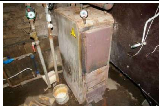
Būve (ēdnīcas ēka) ar kadastra apzīmējumu 6444 004 0242 001, cietā kurināmās apkures katls
